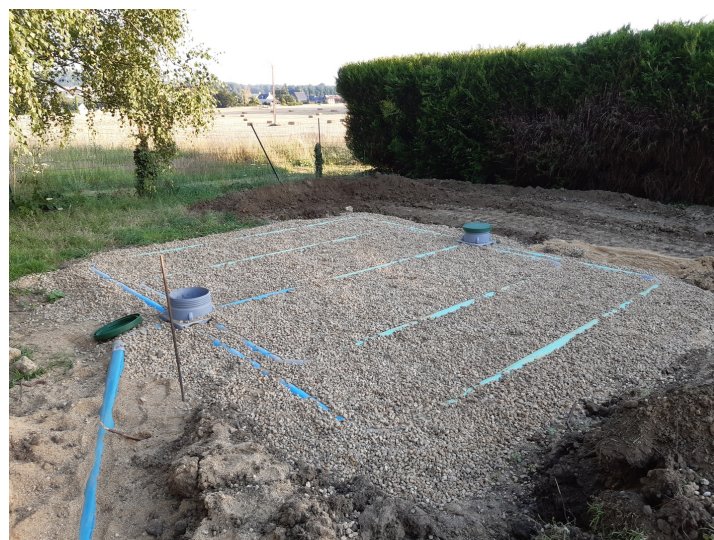
Photo 2 : Filtre à sable vertical non drainé
